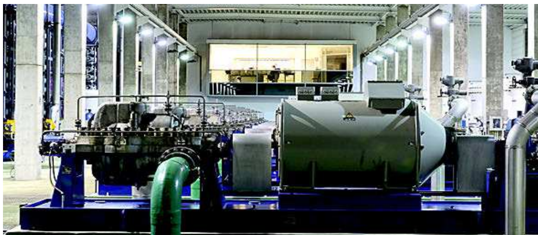
La desalinizadora de Bahía de Palma es la principal fuente de suministro de agua potable en Mallorca.
